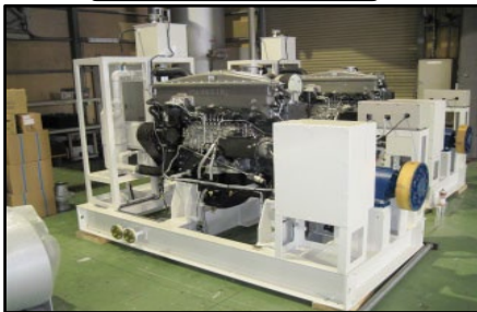
発電機動力装置
