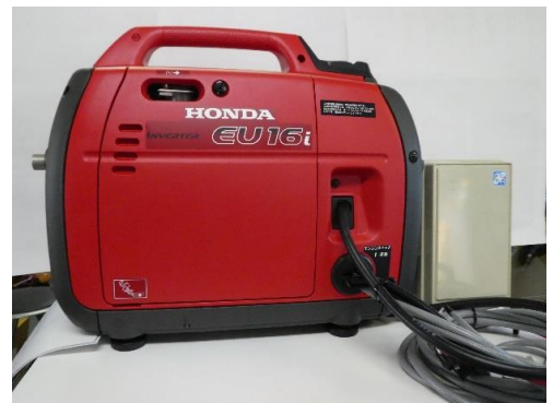
フルオート制御ガソリンエンジン発電機 1.6Kw連続3日間自動運転(商用OFFで始動ONで停止) 月1回10分間自動運転(キャブ内燃料交換) FMコミュニティー送信所多数納入(東北)
