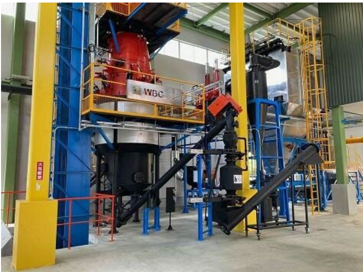
▲ オペレーションを行った、山梨県南部町バイオマスエナジーの木質ガス化発電所
