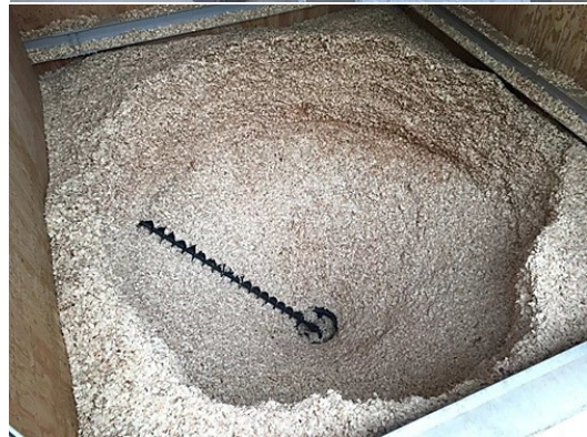
調査・選定等を行いオペレーションを行った、高森町「御大の館・湯ヶ洞」の木質バイオマスボイラー ▶
